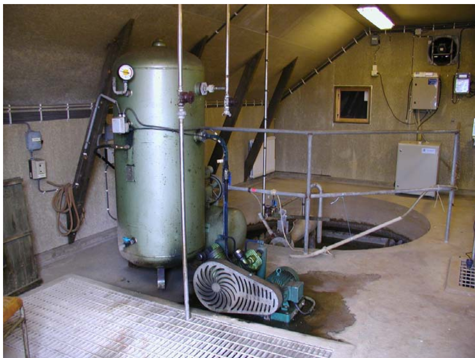
Bö-Ångevikens avloppsreningsverk från mitten av 1970-talet är mycket ojämnt belastat under året. Foto: Maria Hübinette, Länsstyrelsen Västra Götaland
