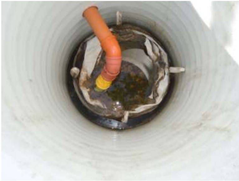
Bild 6 Smutsigt och slammigt fosforfilter.
